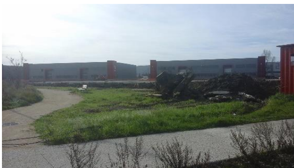
Travaux d'aménagement en février 2020 dans la partie nord de l'aire d'étude rapprochée © Biotope
